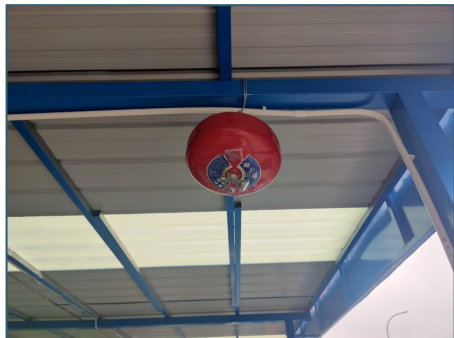
防护棚悬挂式干粉灭火器
