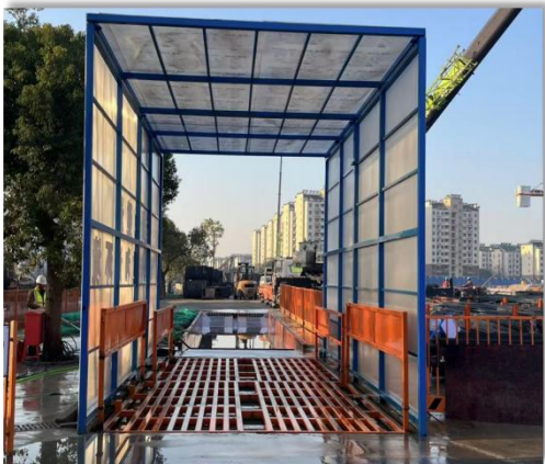
全封闭式洗车池
