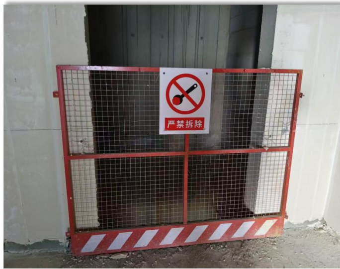
电梯洞口防护
