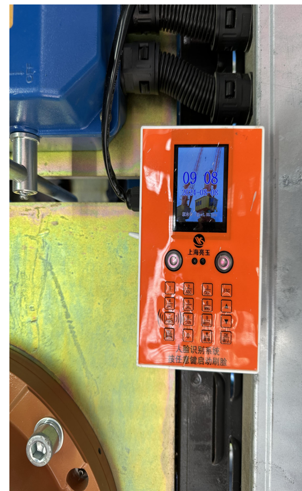
智能无人施工电梯
