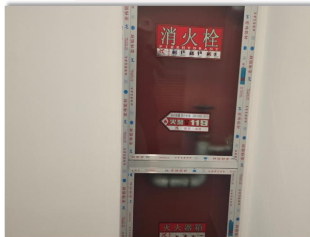
楼层灭火器配置
