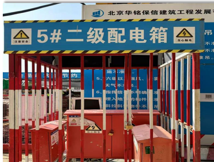
定型化电箱防护棚
