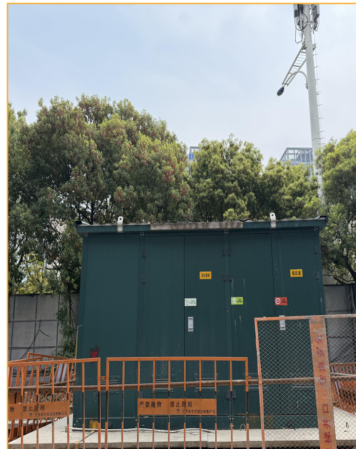
临时用电一级电箱
