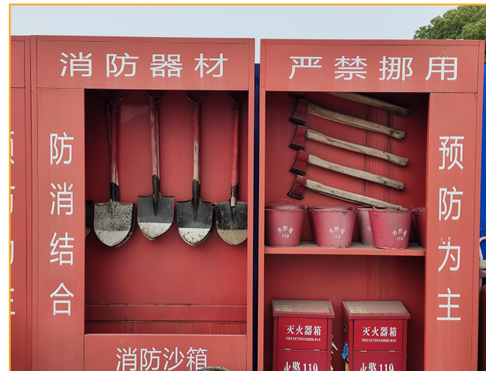
消防灭火器材
