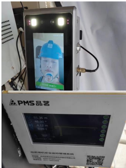
塔机安全监控管理系统
