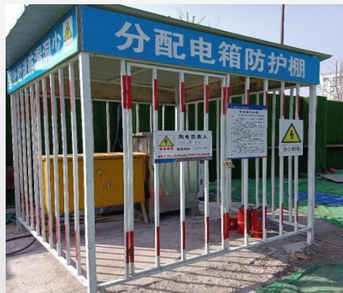
定型化临电设施
