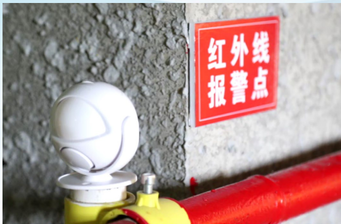
临边防护红外线监控
