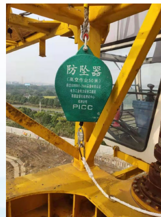
塔吊上下人员防坠器
