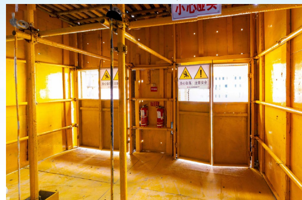
接料平台全封闭防护
