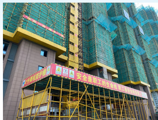
升降机防护通道
