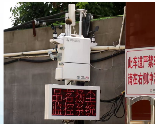
扬尘监控系统
