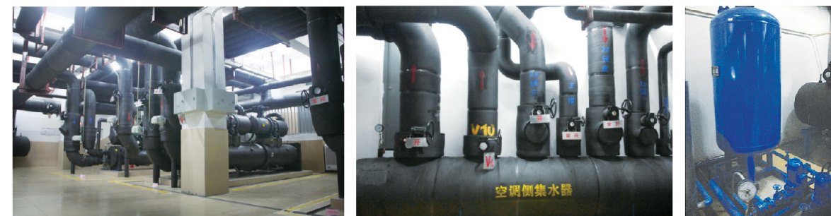
三馆两中心内部土壤源热泵机组
