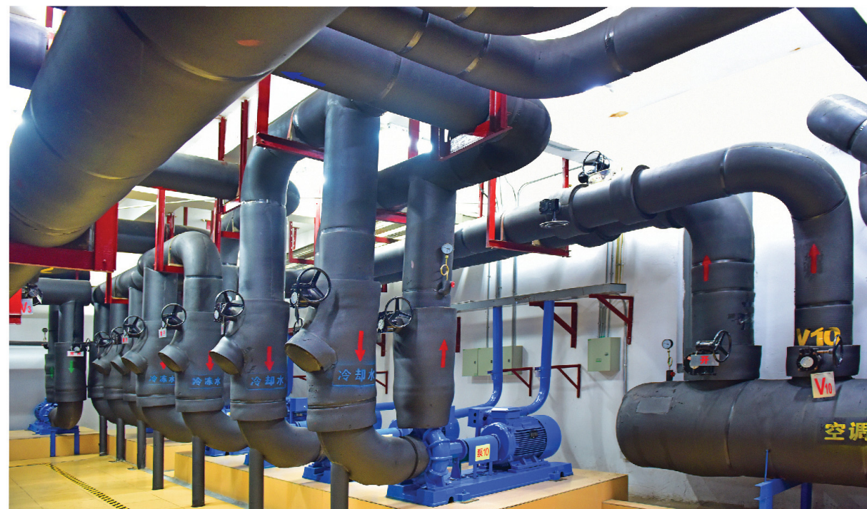
民族工商业档案馆内土壤源热泵设备机组
