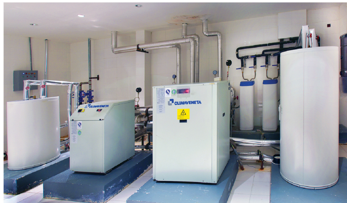
蠡湖香樟园内土壤源热泵设备机组
